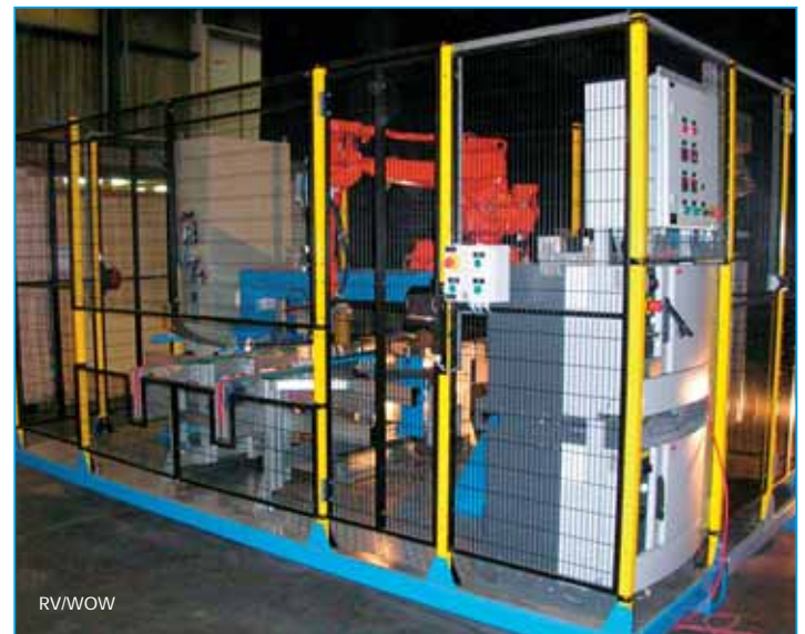
Sécurisation de l'installation : une enceinte de sécurité munie de portes d'accès de catégorie 4 et d'arrêts d'urgence qui stoppent la ligne dès qu'ils sont enfoncés.
